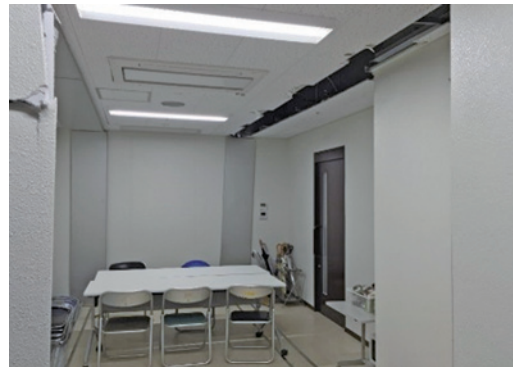
エキスパンションジョイント金物破損・落下
