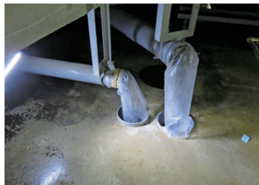
給水管の損壊
