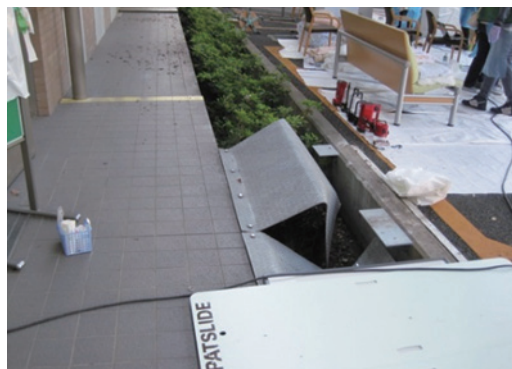
緑エリア搬入口の天板破損
