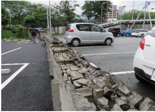
ブロック塀の倒壊
