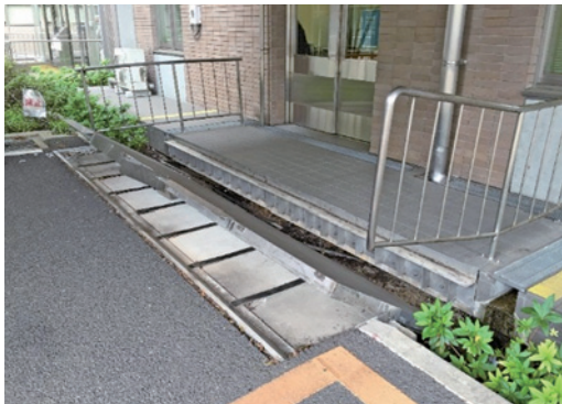
エキスパンションジョイント金物破損
