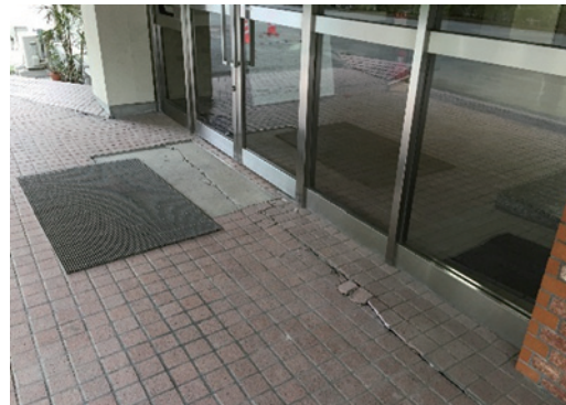
玄関土間のクラック
