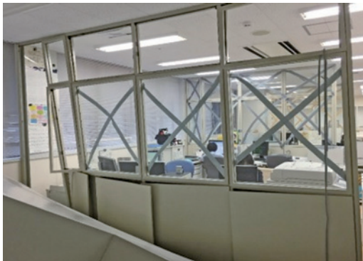
パーティションの損壊
