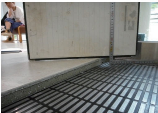
エスカレーター 床段差
