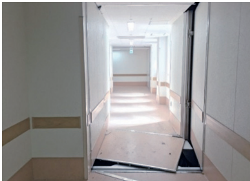
渡り廊下 被災
