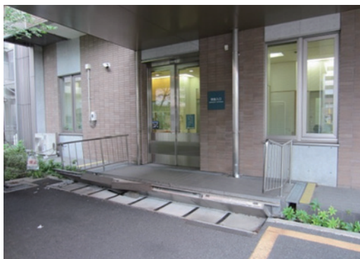
救急搬送入り口の天板破損
