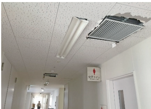
照明器具・空調機の損壊
