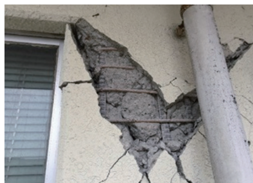
4階柱のせん断破壊
